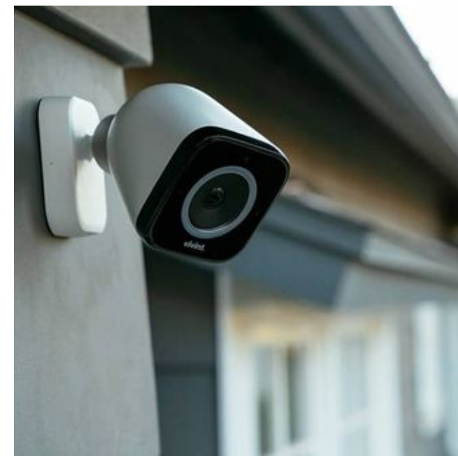
SISTEMA DE ALARMA Y CCTV
